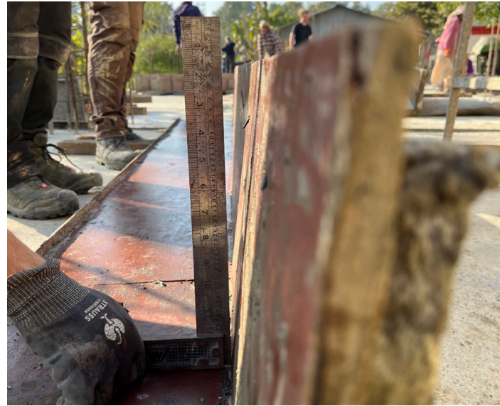
Schadhafte Fertigschalungen Abbildung Bindl Raphael
