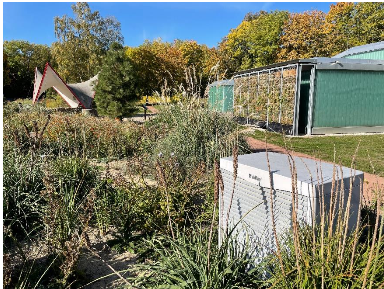
Abb. 2: Wärmepumpe vor der Innovationswerkstatt am Standort Bernburg (Heiner Hensen)
